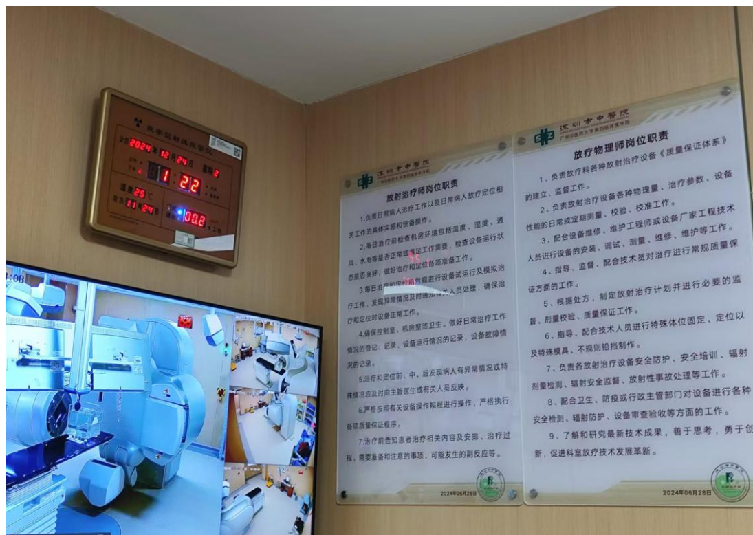
图 3-8 直线加速器控制室制度上墙情况
