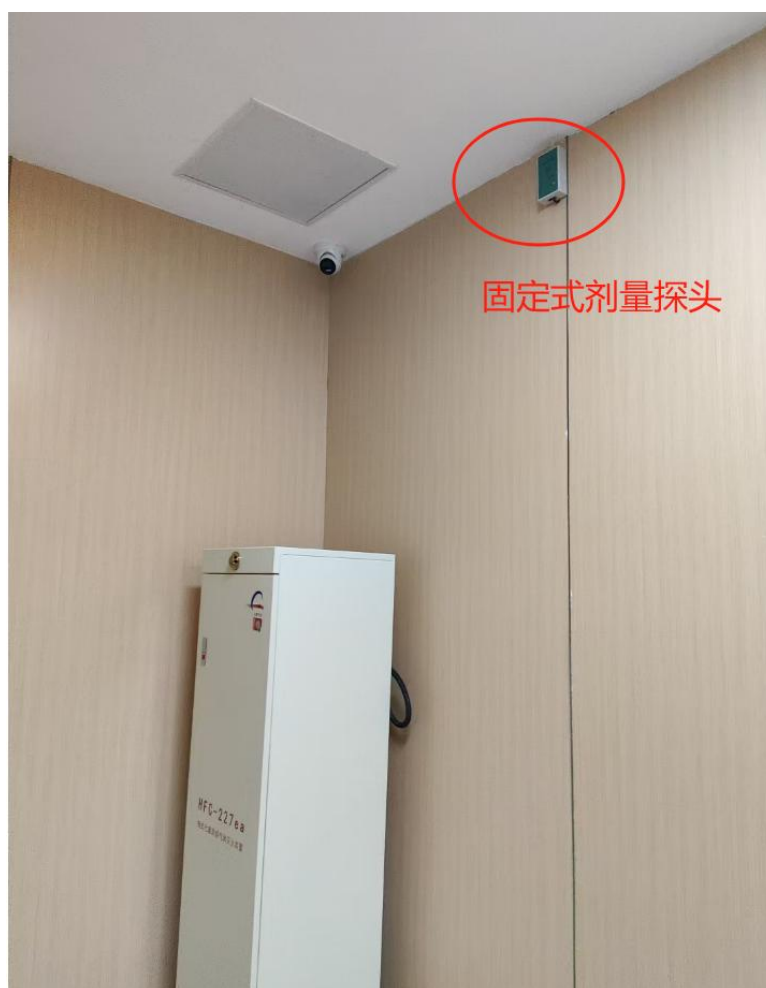
图 3-5 直线加速器机房部分视频监控、急停开关、对讲装置等设施
